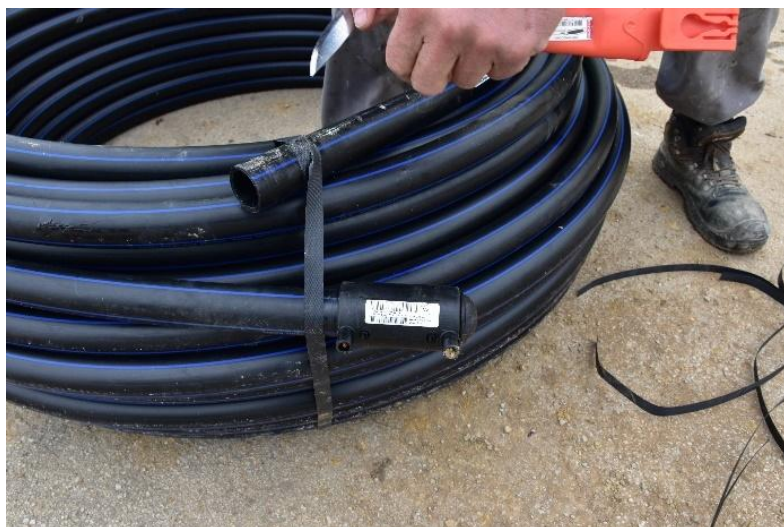
Slika 6: Izgled opazovalne cevi pred pripravo za vgradnjo
